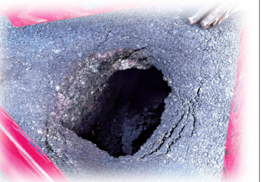
路面出现的空洞。
