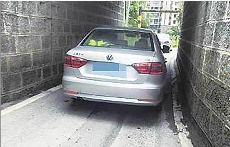
8月12日，有市民反映，双清区大坡路铁路涵洞下道路凹凸不平，过往的机动车行驶摇摇晃晃容易刮上洞壁。市民希望有关部门能将此段道路修复平整。邵阳日报记者 伍洁 摄
