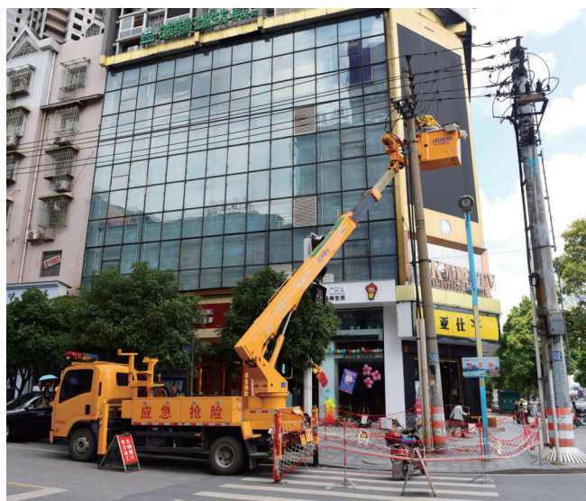
7月3日,国网邵阳供电公司抢修队工人正在市区青龙桥头东风路口更换电缆刀闸。 申兴刚 摄
