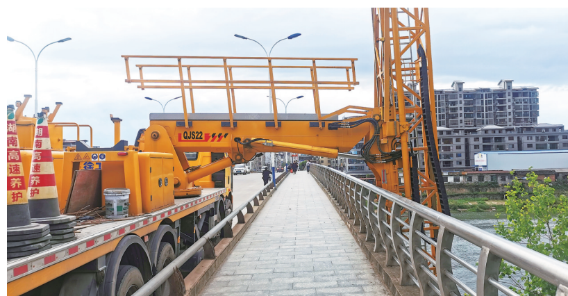
4月27日,桥梁检测车在新宁县夫夷江湘水大桥上对桥梁进行检测。近日,该县对跨江大桥底部进行全面检测,排查隐患,确保汛期桥梁安全畅通。邵阳日报通讯员 郑国华 摄
